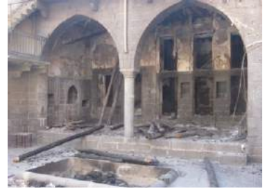
201 ada 49 nolu parselde bulunan ve çatışmalar sırasında yakılan tescilli yapı:
