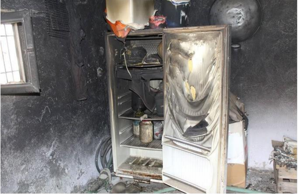
Fotoğraf: Yakılmış ve ağır hasar gören bir evin mutfağı.
